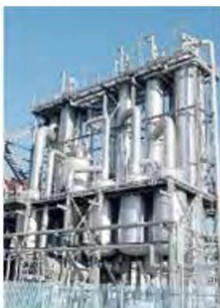
ENERGIA Un impianto di cogenerazione
